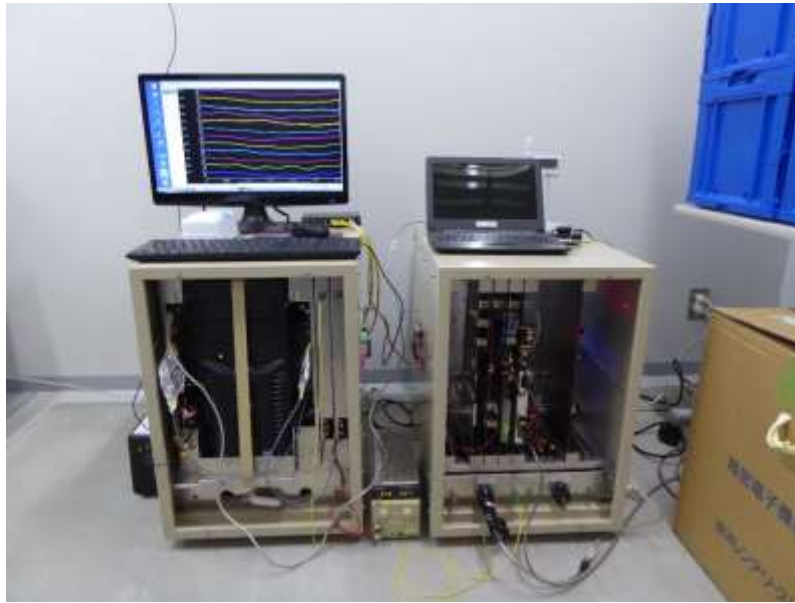
写真 2 観測室内の光送受信装置の設置状況
